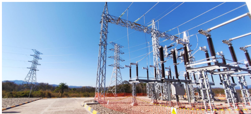
Subestación Bermejo, Tarija
